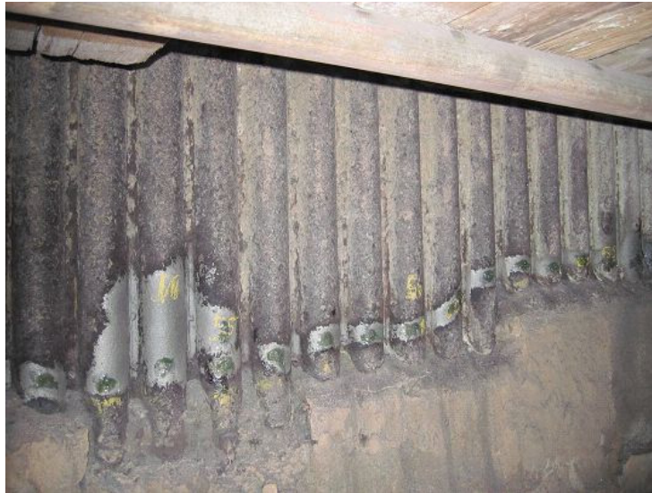
Figur 6. Bilden visar en vattenvägg i en av Renovas pannor. Det är bara ena sidan av panelväggen, insidan, som exponeras mot de korrosiva rökgaser vilka bildas vid förbränningen av soporna. I bildens nederdel syns de med kiselkarbidmassa skyddade kolstålsrören. Kiselkarbidmassan skyddar mot korrosion men minskar samtidigt värmeöverföringen. Ovanför massan syns de oskyddade kompondrören, efter i detta fall 4 års drift.
