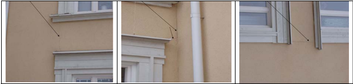
Figur 10. Sprickbildning i den putsade fasaden. Foto Ingemar Nilsson SP.
