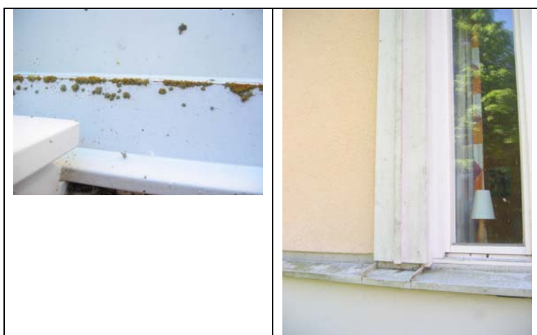
Figur 14. Fönsterbleck samt utsida av yttre karmar och fönsterfoder som visar en viss påväxt av mögel och alger. Foto Finn Englund SP-Trätek.
