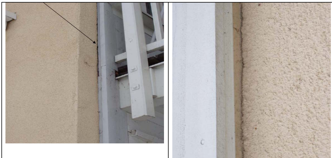
Figur 13. Materialmötet trä – puts. Där pilen sitter visas otätheter där vatten kan tränga in i stora mängder och skapa fuktproblem i den bakomliggande väggkonstruktionen. Foto Ingemar Nilsson SP..
