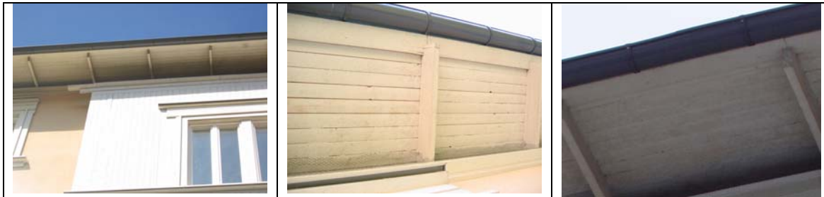
Figur 15. Foto på takutsprången som synes vara i gott skick, förutom att det finns en del mögelpåväxt här och var. Foto Finn Englund SP-Träteck och Ingemar Nilsson SP.
